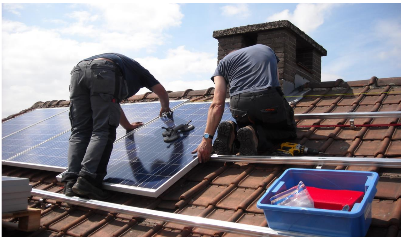
Energia Solar Residencial: Geração distribuída de uma casa
